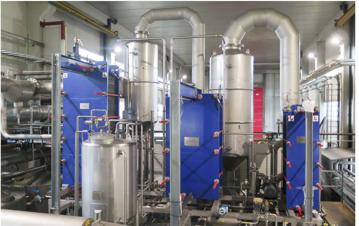
Vakuuminndamper på Hamar K1
