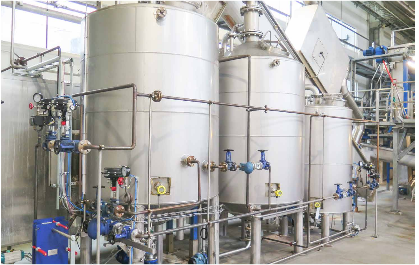
Anlegg for sterilisering av fett på Hamar K1
