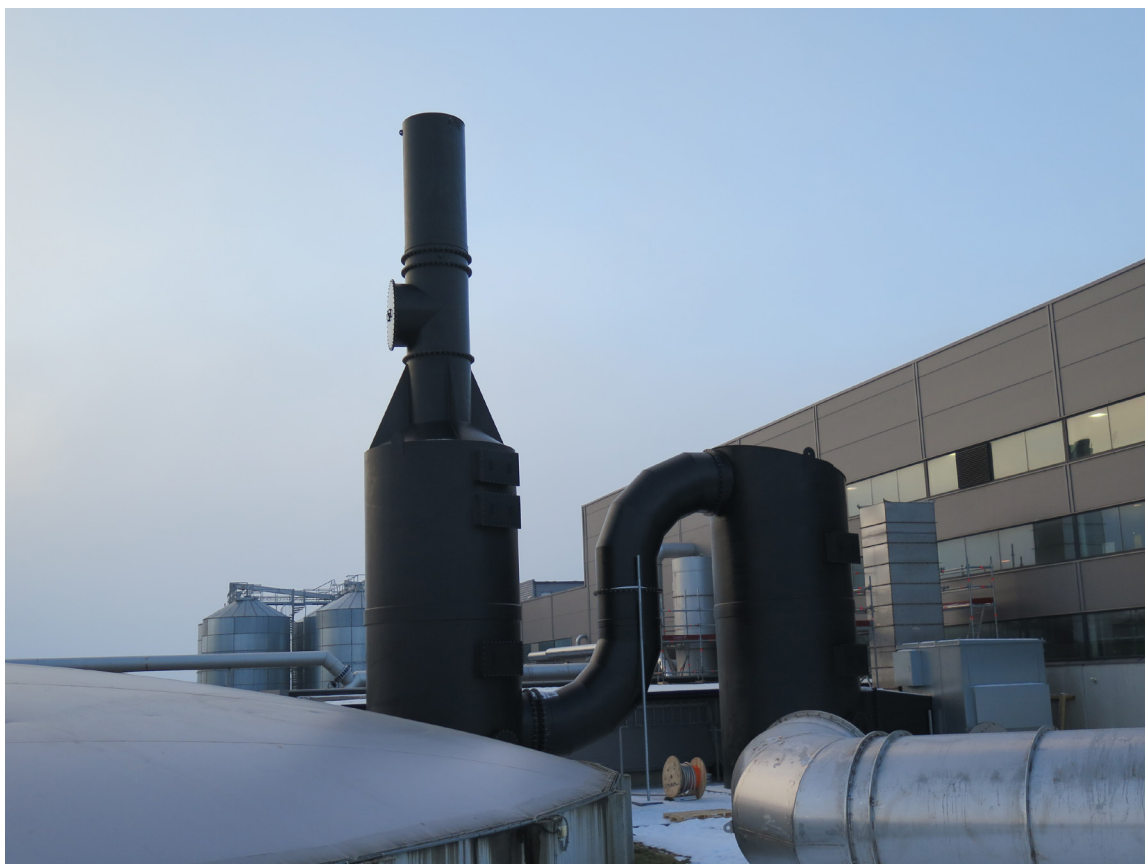
Ny kjemisk luftvasker ved anlegget på Hamar
